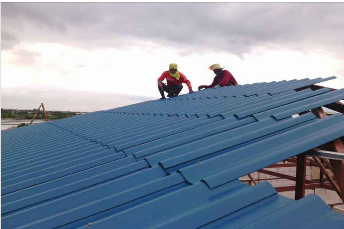
งานโครงสร้างหลังคาและ มุงกระเบื้องหลังคาลอนคู่
