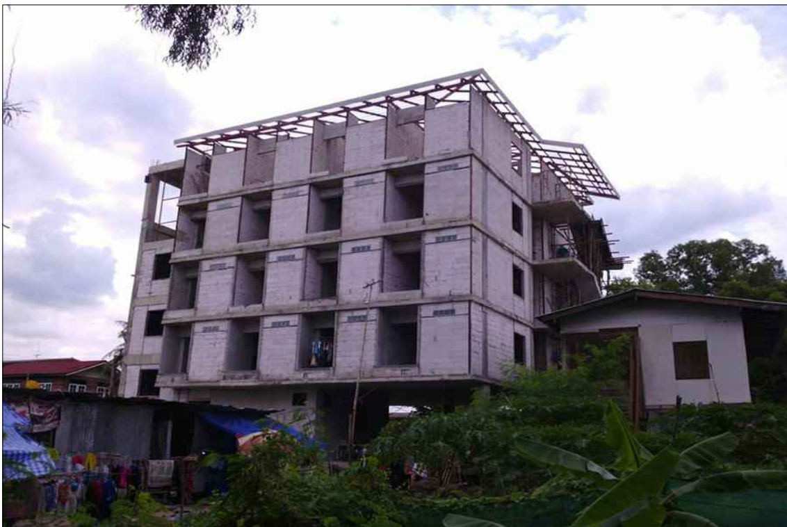
งานปูกระเบื้องพื้นและ งานโครงสร้างหลังคา
